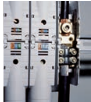
Közvetlen csatlakozás Al/Cu
